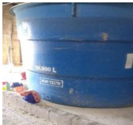
Foto 4 - Caixa d'água para reuso de água
